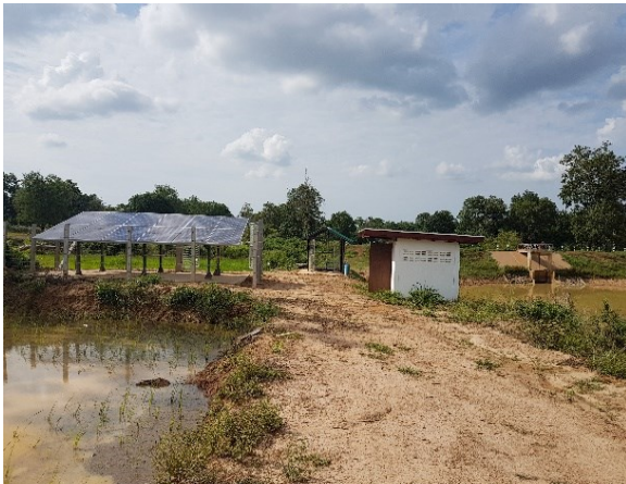
ระบบสูบน้ำด้วยพลังงานแสงอาทิตย์ ซึ่งก่อสร้างไว้ในบริเวณสระน้ำสาธารณะ
